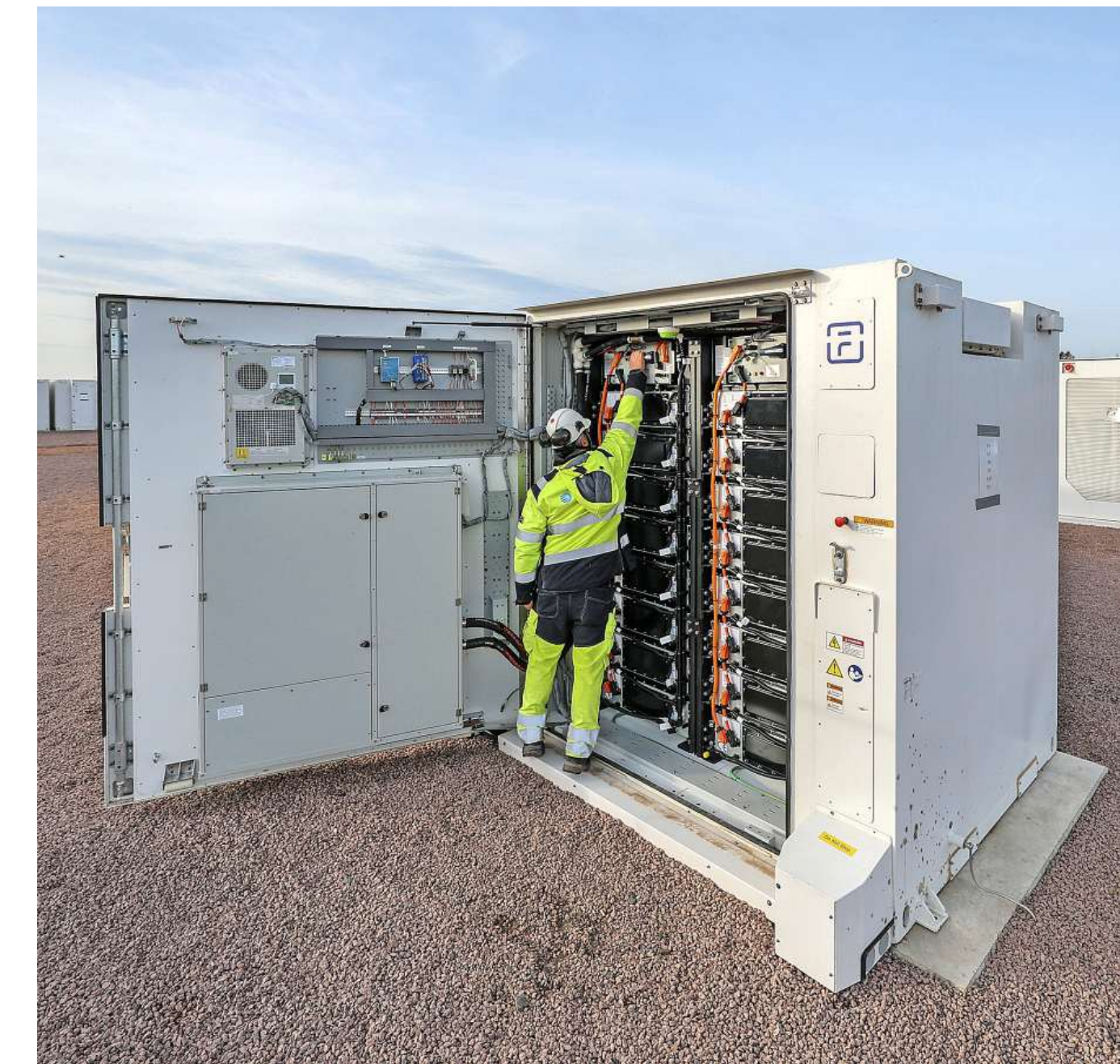
Hilft bei der Stabilisierung des Netzes: Batteriespeicher neben einer Solaranlage in Sachsen-Anhalt
